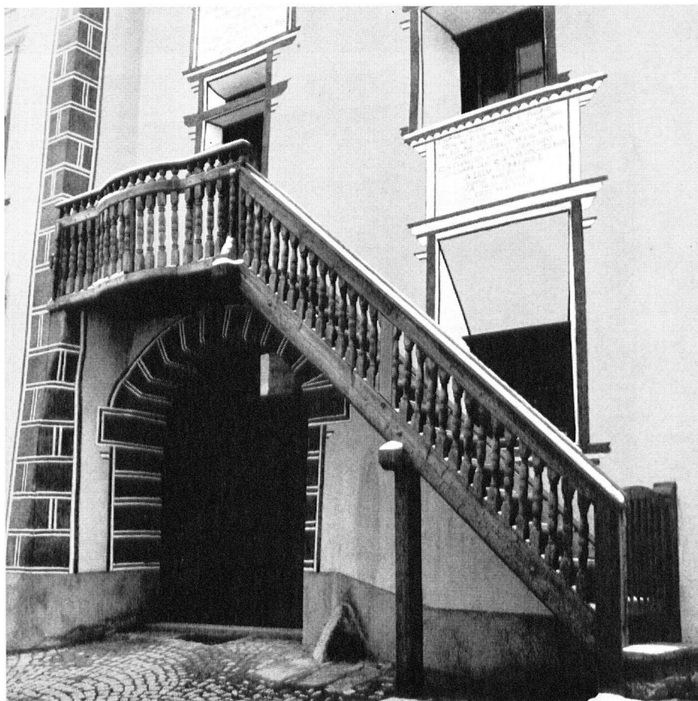
Ftan. Encore une maison engadinoise caractéristique. Bâtie en 1674 pour le pasteur J. A. Vulpius. Deux photos: l'une avant, l'autre après la restauration (1966). Entreprise pleinement réussie; nombreuses sont les demeures grisonnes qui mériteraient les mêmes soins.
