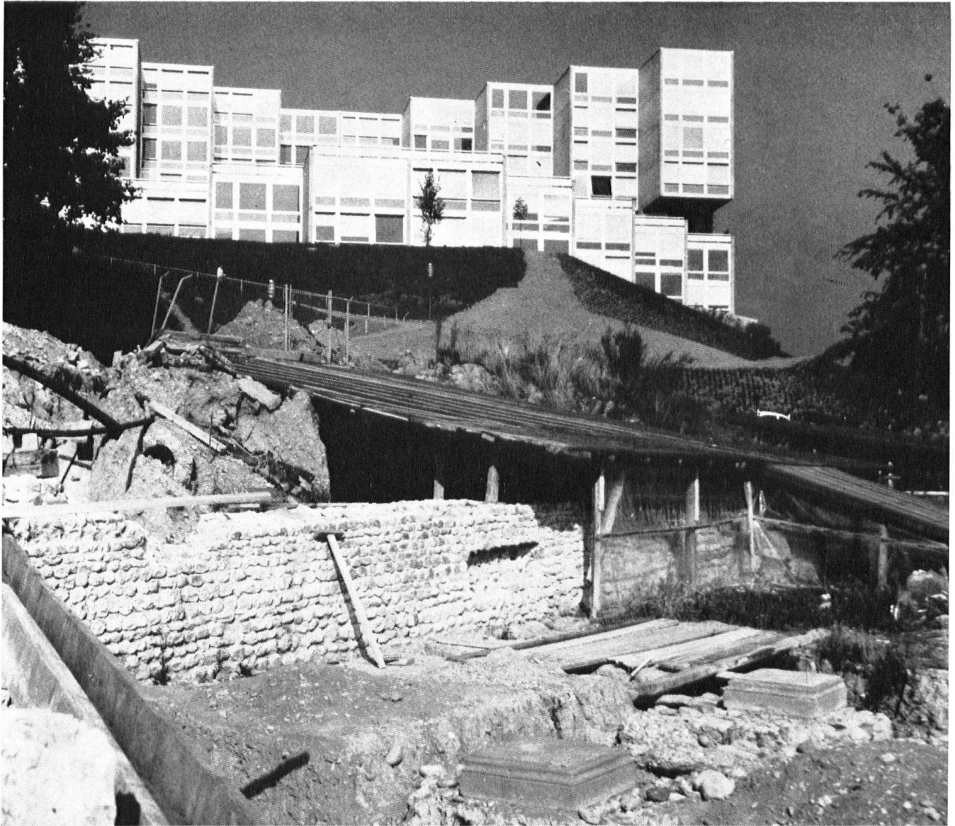
Die nahe der Rhone, unterhalb der Altstadt, ausgegrabenen und konservierten Mauern der Kirche des einstigen Clunienserklusters St-Jean; im Vordergrund (Mitte und rechts) zwei Pfeilersockel. Der markant profilierte Hausblock im Hintergrund gehört zur Neuüberbauung des Quartiers von St-Jean.
