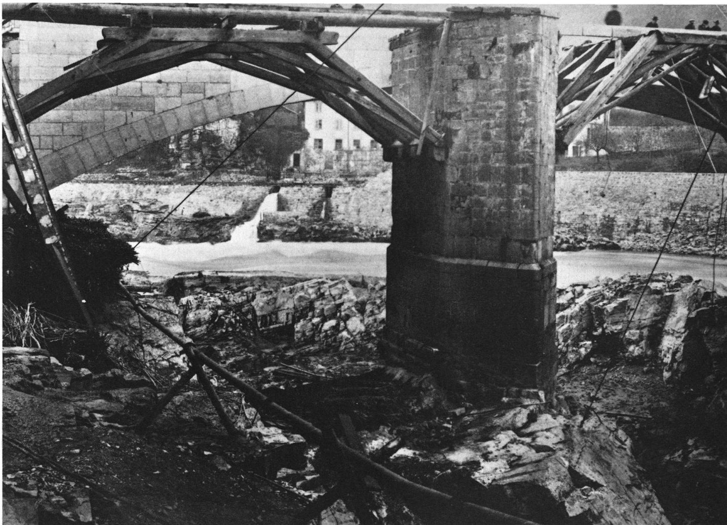
Trapezspengwerke der ungedeckten Holzbrücke über den Rhein in Laufenburg während der Abbrucharbeiten im Januar 1912. Da hier das gesamte Tragsystem unter die Fahrbahn zu stehen kam, erübrigte sich die Überdeckung.
