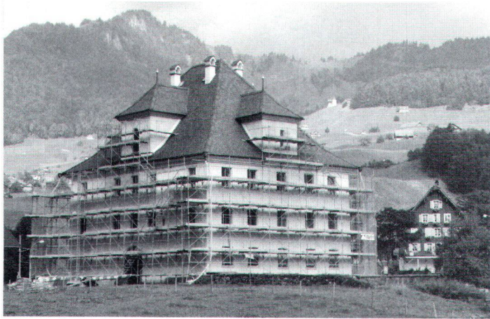
Mitten im Talboden: das Herrenhaus Grafenort während der Renovationsarbeiten im Sommer 1994. (Bild Kloster Engelberg)
