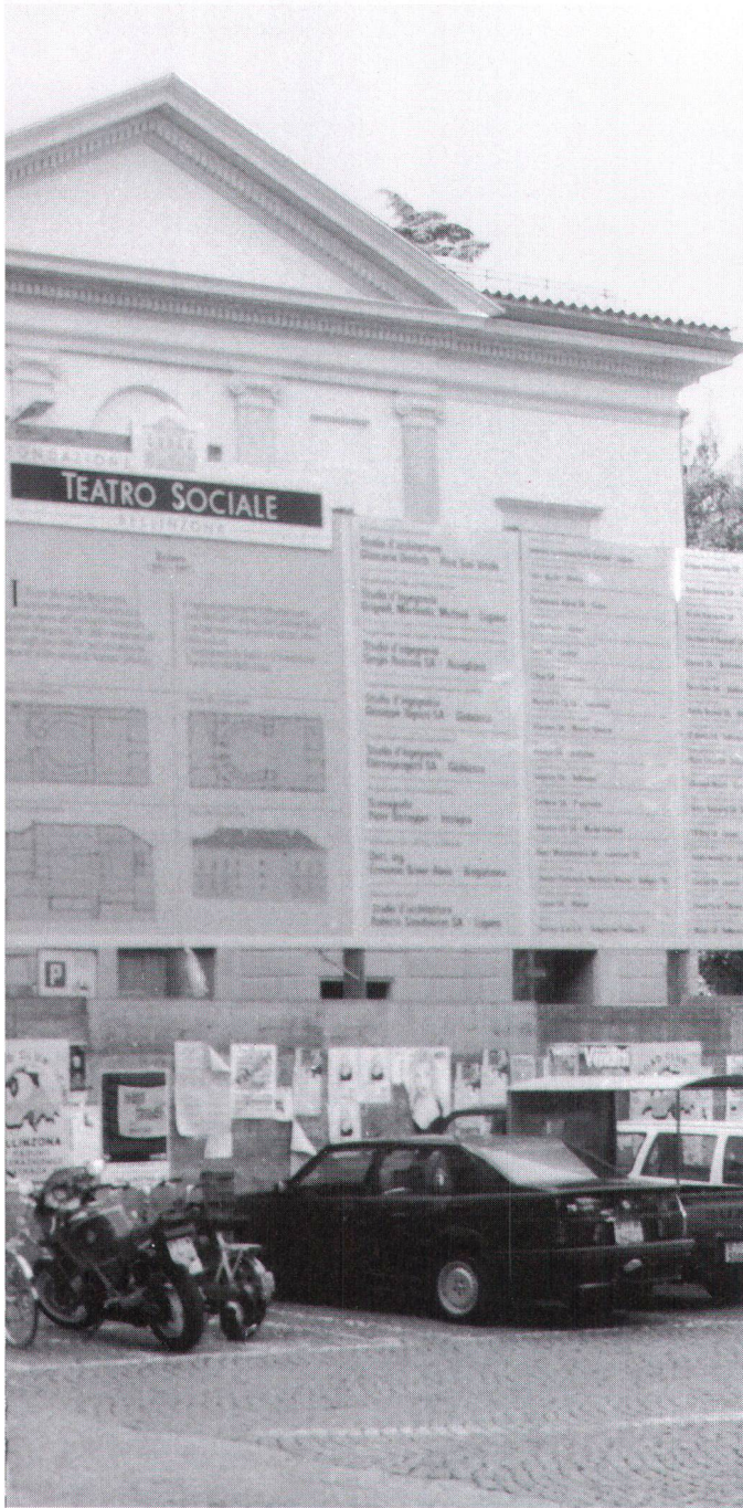
Bis im Frühjahr 1997 werden die Renovationsarbeiten am Teatro sociale abgeschlossen sein. Kleines Bild: Logenansicht vor dem Umbau (Bilder SHS)
