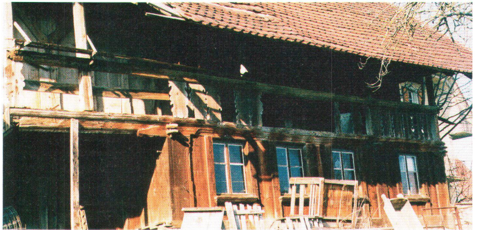
Die Sektion Freiburg wehrt sich mit einer Beschwerde gegen den Abbruch dieses Bauernhauses in Cressier (Bild SAP)
