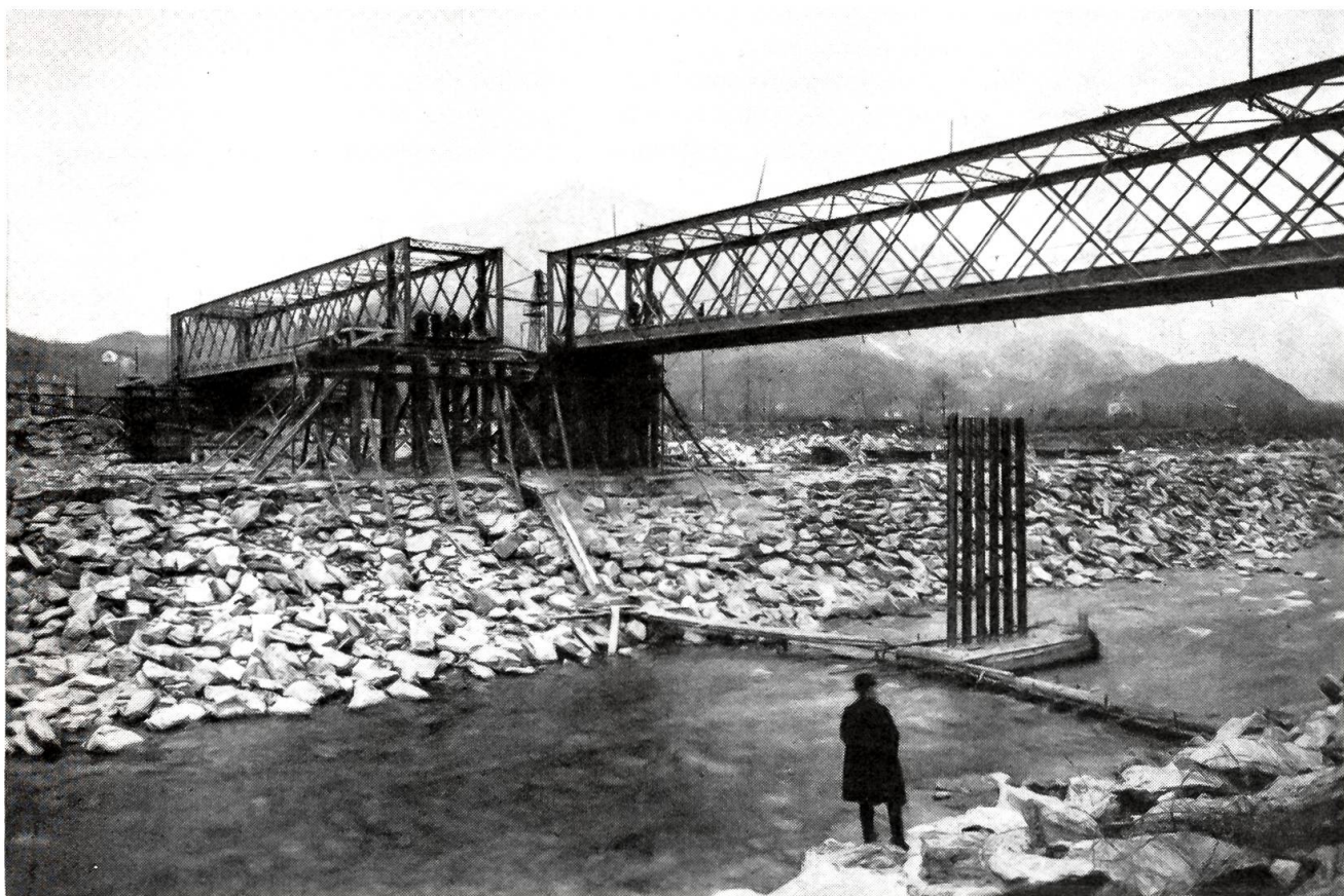
Eine interessante Brückenverschiebung bei Locarno. Phot Et inemann, Locarno. Um einer neuen Eisenbetonbrücke Platz zu machen, wurde die 100 Meter lange und 450 Tonnen schwere Maggiabrücke bei Locarno in zwei Teilen seitlich verschoben und diente bis zur Fertigstellung der neuen Brücke dem Verkehr weiter.
