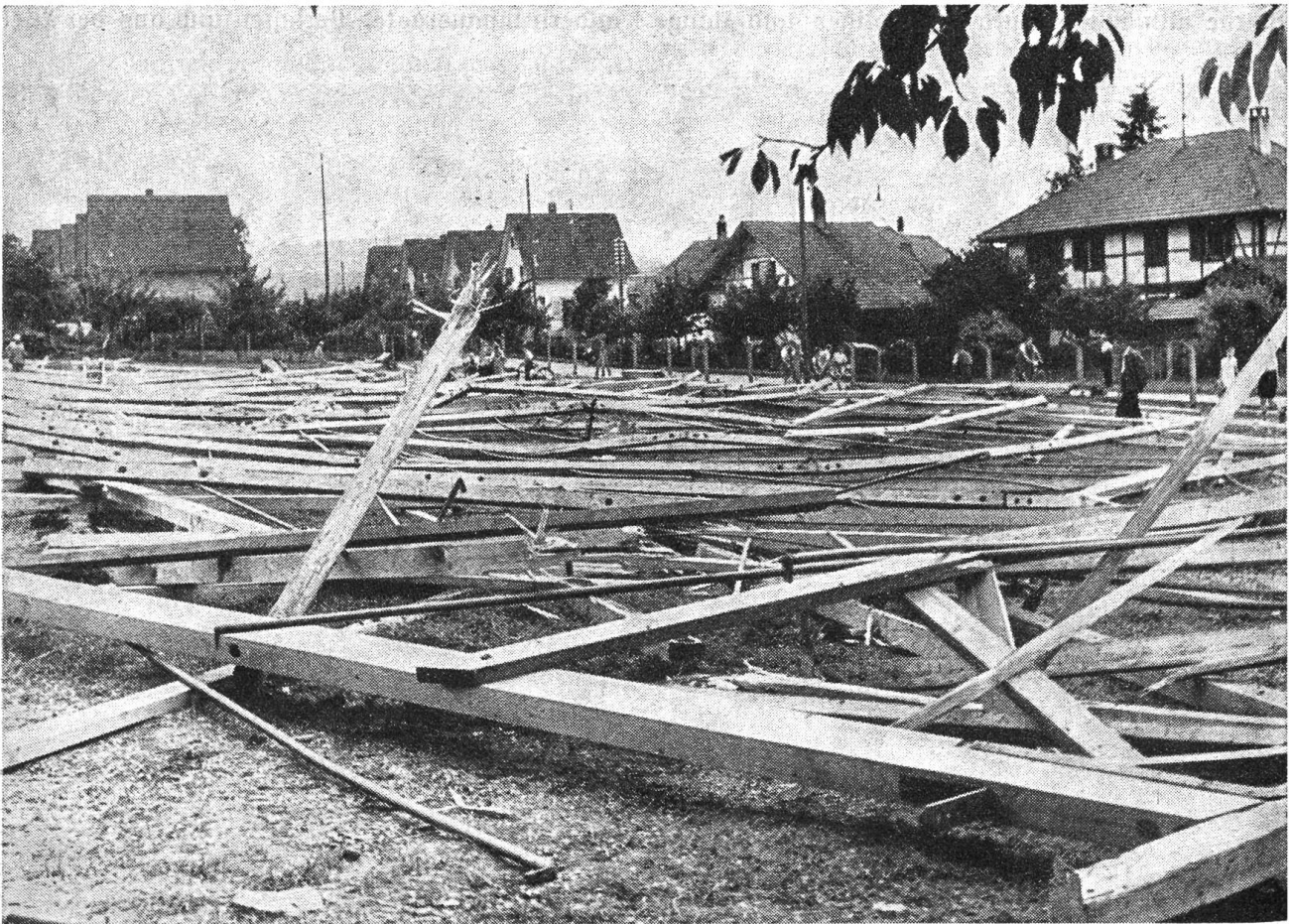
Beim Abbruch der für das kantonalerbnische Zoderfest erstellten Festhalle stürzte infolge einer falschen Manipulation an der Seilwinde die ganze 90 m lange Halle ein.
