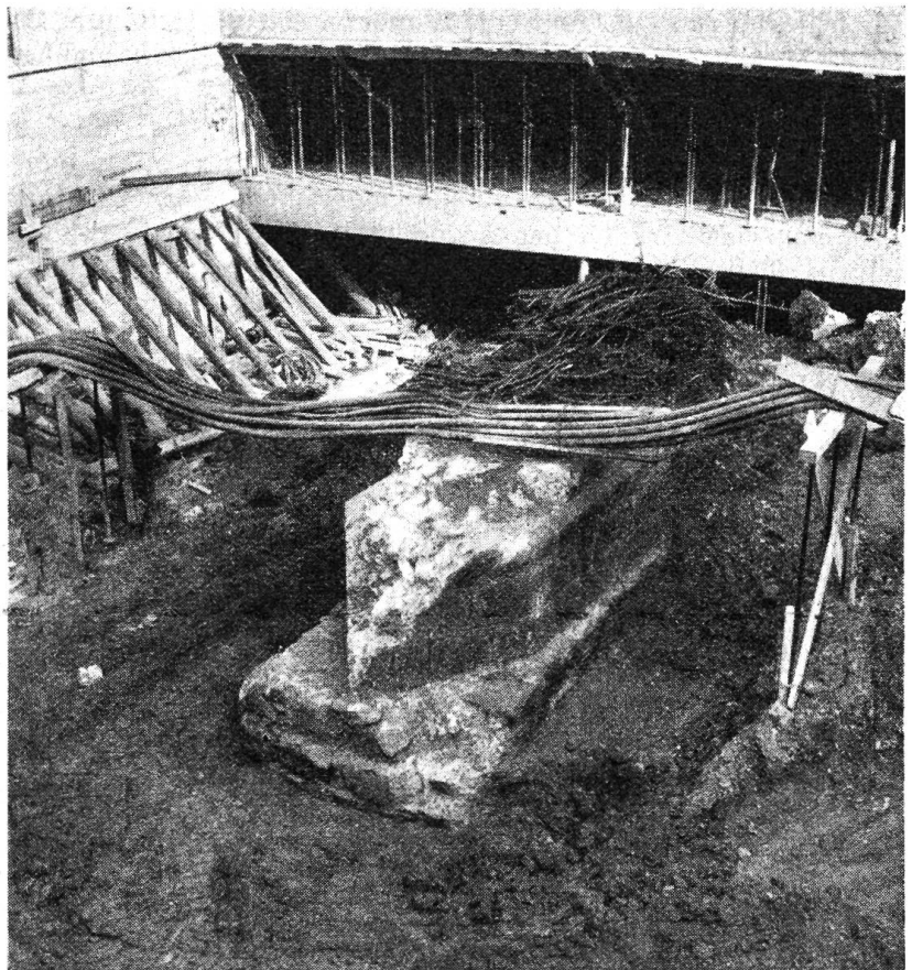
Dieser Pfeiler ist der letzte Überrest einer Holzbrücke, die vor Jahrhunderten in Bern die Narberggasse mit der Zeughausgasse über den Stadtgraben verband. Er kam bei den Aushubarbeiten für die neue Autogarage auf dem Waisenhausplatz zum Vorschein.
