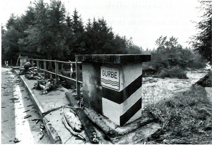
Zerstörungen im Gürbetal Schwere Unwetter im Sommer 1990 richteten in der Gegend von Wattenwil BE grosse Verwüstungen an Gebäuden, Strassen, Kulturen und Infrastrukturanlagen an. Das Unwetter hauste auch im Gurnigelgebiet und im Raum Laupen. (Photo: Keystone-Press, Zürich)
