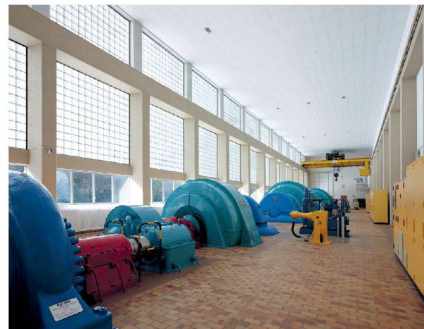
^EWZ-Kraftwerk Löbbia. ^Centrale elettrica EWZ di Löbbia.
