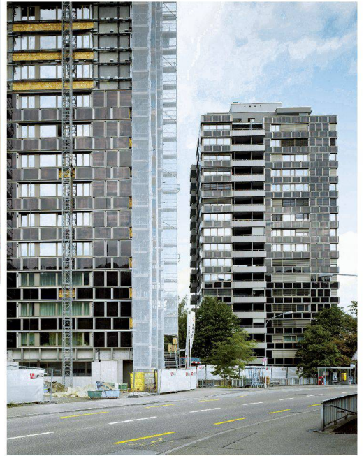
^Die Fotovoltaikfassade zeigt die neue Energieeffizienz.
