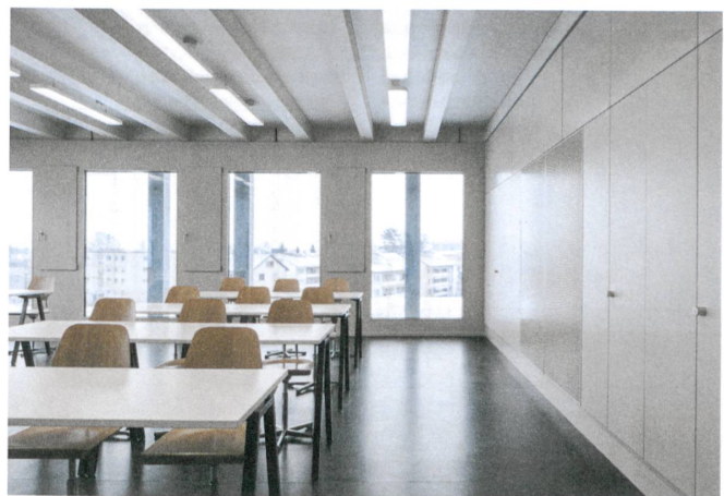
Die Decke der Klassenzimmer zeigt die Tragstruktur, die sich mit den äusseren Stützen verbindet.
