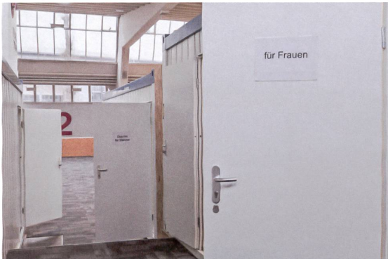
Sanitärcontainer am Ende der Halle.
