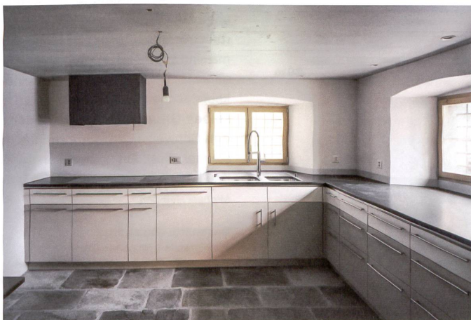
Die zur Cucina lasierte Betondecke steift den Altbau aus und verteilt Leitungen.
