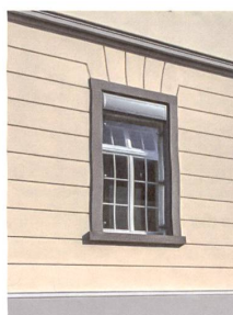
Flächige Glasscheiben vor den Fenstern statt Gitter.
