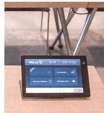
An solchen Stationen loggen sich die Nutzer der Büroräume ein.
