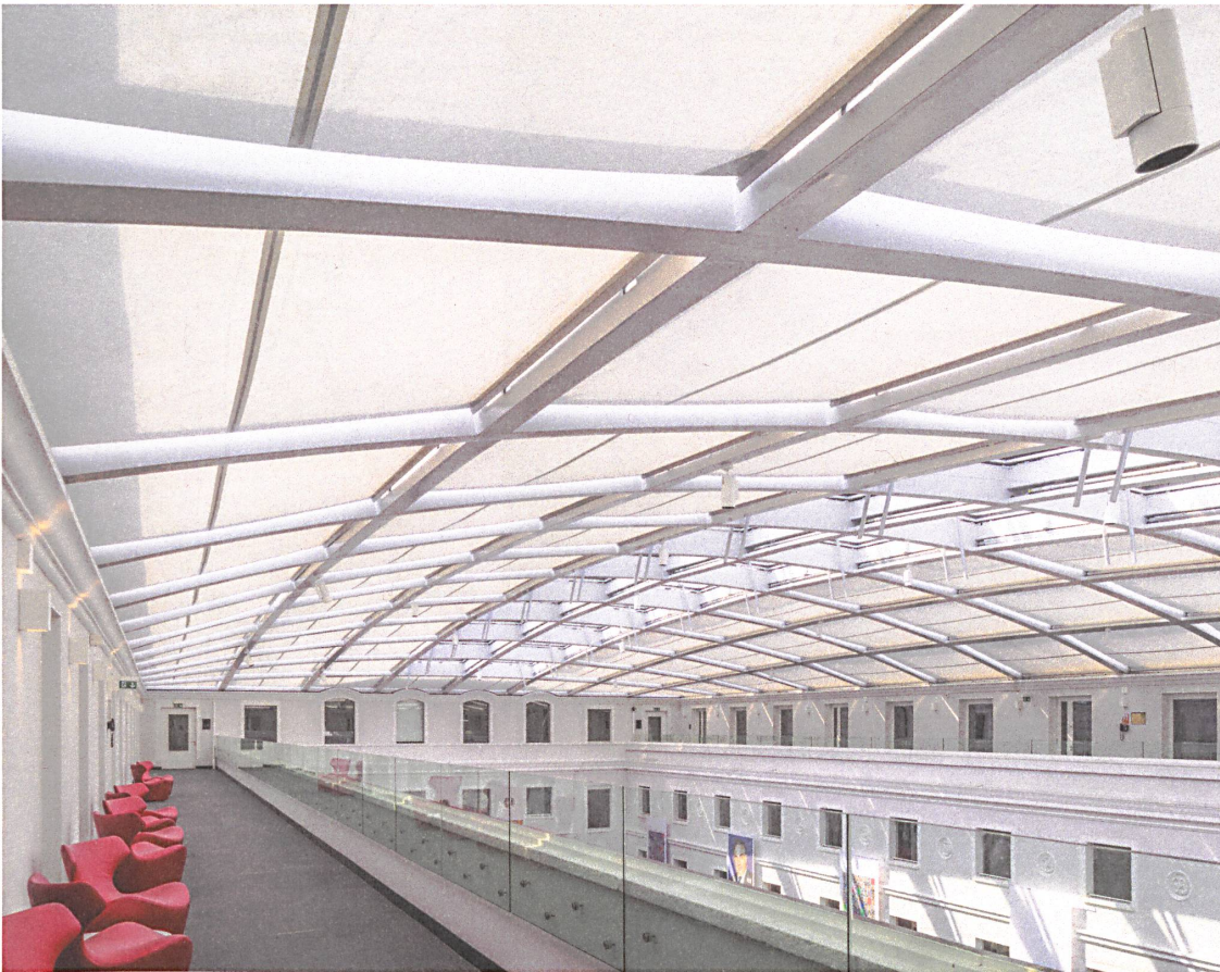
Durch die gegen alle Seiten hin gekrümmte Dachkonstruktion entsteht eine scheinbar unter Spannung stehende Membran. Fotos: Johannes Marburg
