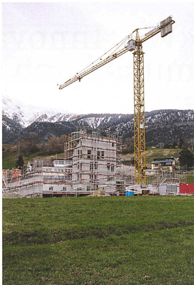
Der Rohbau macht einen bedrohlichen Eindruck. Doch nach der Fertigstellung wird der soziale Wohnungsbau an eine grosse Walliser Scheune erinnern – und ermöglicht gleichzeitig, dass ein grosser Teil der Wiese unbebaut bleibt.
