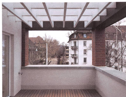
Ziegelstützen? Darin verstecken sich Holzstützen.
