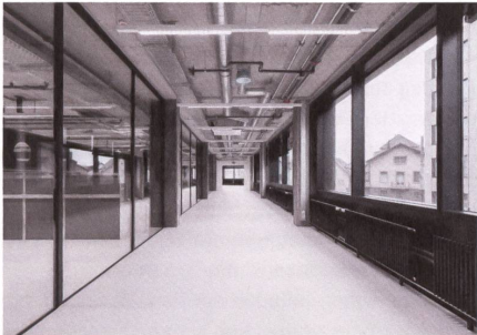
Die Gebäudetechnik wird offen geführt.
