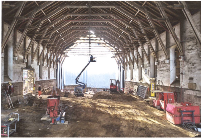
Das Dach wurde bei der Stirnfassade geöffnet, um die Kuben für die Nebenräume zu betonieren. Foto: Luca Zanier
