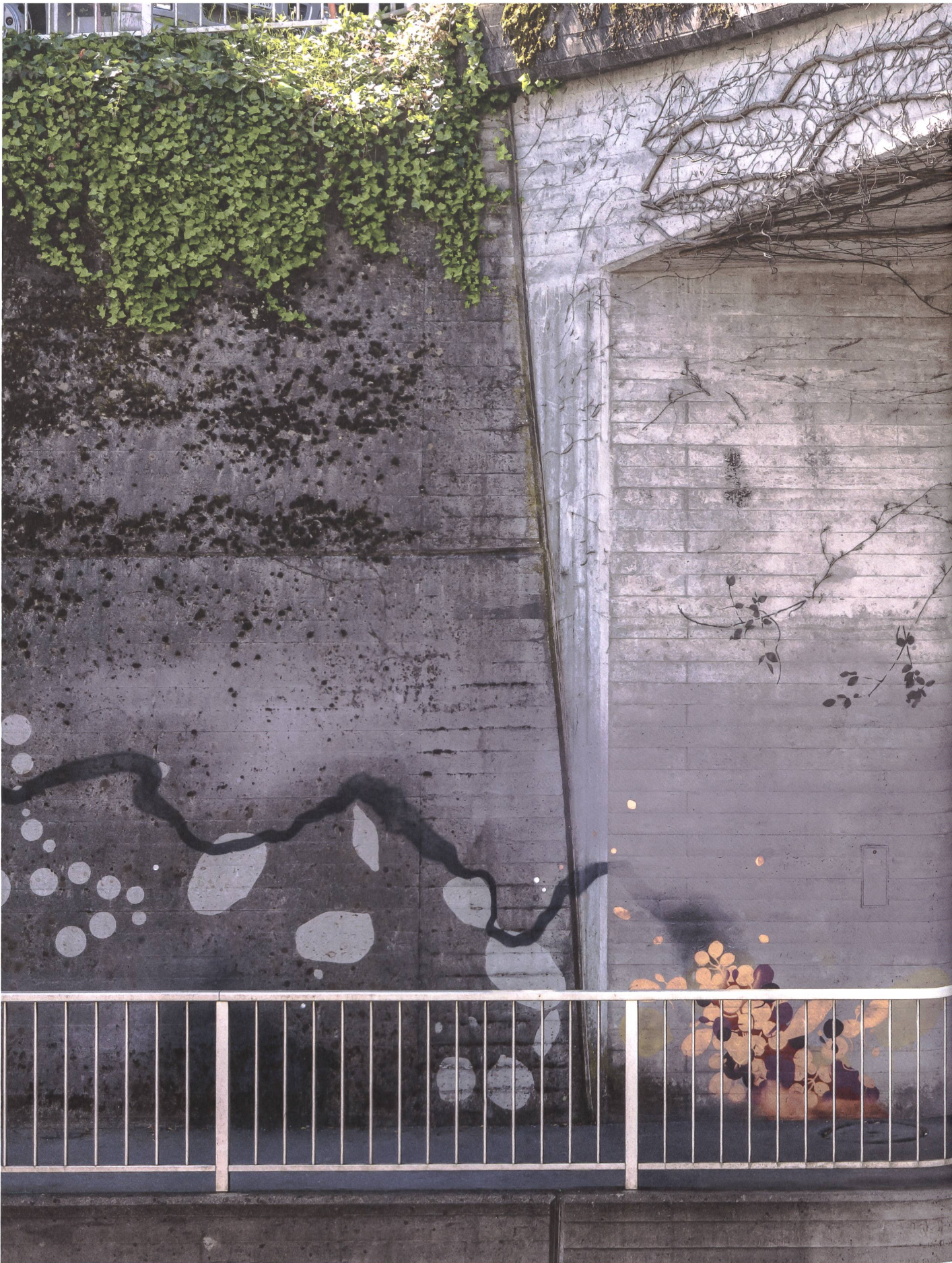
Unterführung am Bahnhof Jona: Mit Hochdruckreiniger, Malerei und Street Art haben Gen Atem / Miriam Bossard Ablagerungen und Moose zu einem Bild erweitert.
