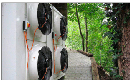
Mit Ventilatoren holt man die Wärme zum Heizen aus der Luft.
