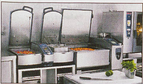
Mit «ConnectedCooking» vernetzte Geräte lassen sich einfach und komfortabel steuern.
