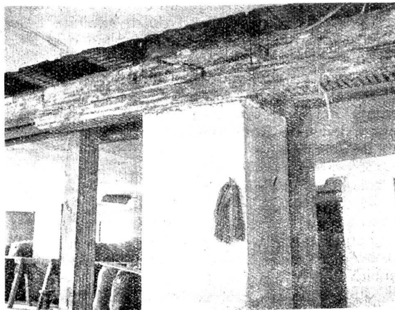
Abbildung Nr. 2. Geöffnete Stoßfuge über dem Pfeiler.
