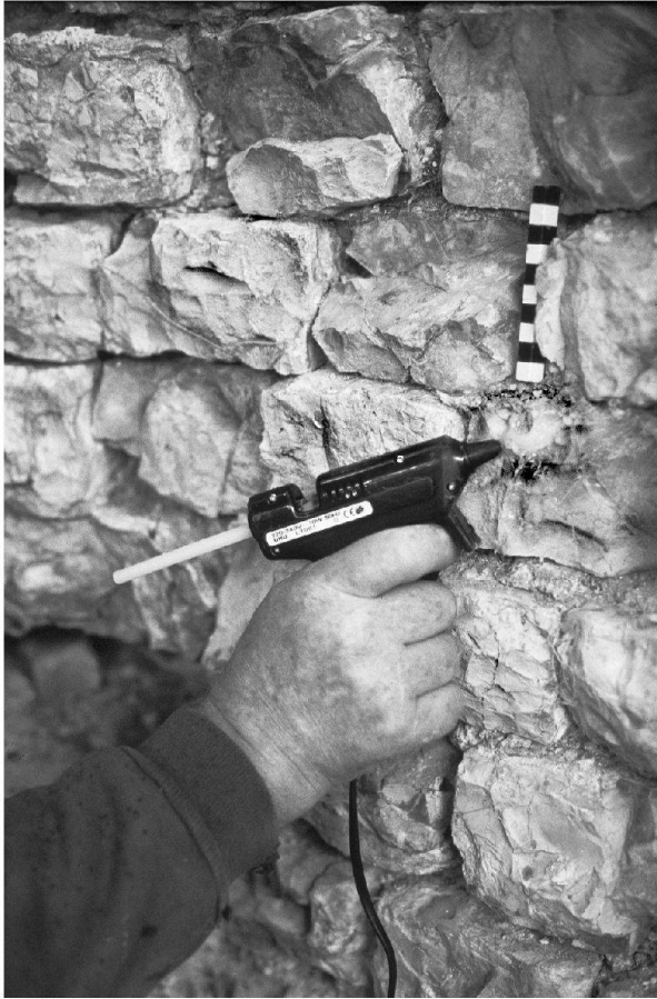
Abb. 39: Augst, Theatersanierung (Grabung 2004.055). Peripheriebereich Keil 3, Mauerinnenschale des Entlastungsbogens MR 131. Detail der Feinrestaurierung von Mauerschalen: Vor dem Ausinjizieren von Haarrissen in den Muschelkalkquadern der Mauerschale mit einem Injektionsharz werden mögliche Flüssigkeitsaustritte mit einem Heissiegelkleber abgedichtet. Maurer Max Heid mit der Klebepistole.
