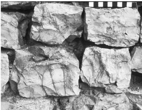
Abb. 41: Augst, Theatersanierung (Grabung 2004.055). Peripheriebereich Keil 3, Mauerinnenschale des Entlastungsbogens MR 131. Die Feinsanierung der Schalenquäderchen ist abgeschlossen und der zum Abdichten verwendete Heissiegelkleber wurde von den Steinen abgezogen; die Mauerpartie ist zum Verfügen bereit.
