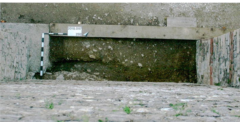
Abb. 57: Augst BL, Basilica-Stützmauern (Grabung 2015.057). Sondierung (Feld 14) entlang der Basilica-Stützmauer MR 21 zwischen den Stützpfilern MR 24 (links) und MR 23 (rechts). Mit der Sondierung sollte die Art und Weise der Fundamentierung der Stützmauer abgeklärt werden (siehe Abb. 58). Von oben, Norden ist oben rechts.
