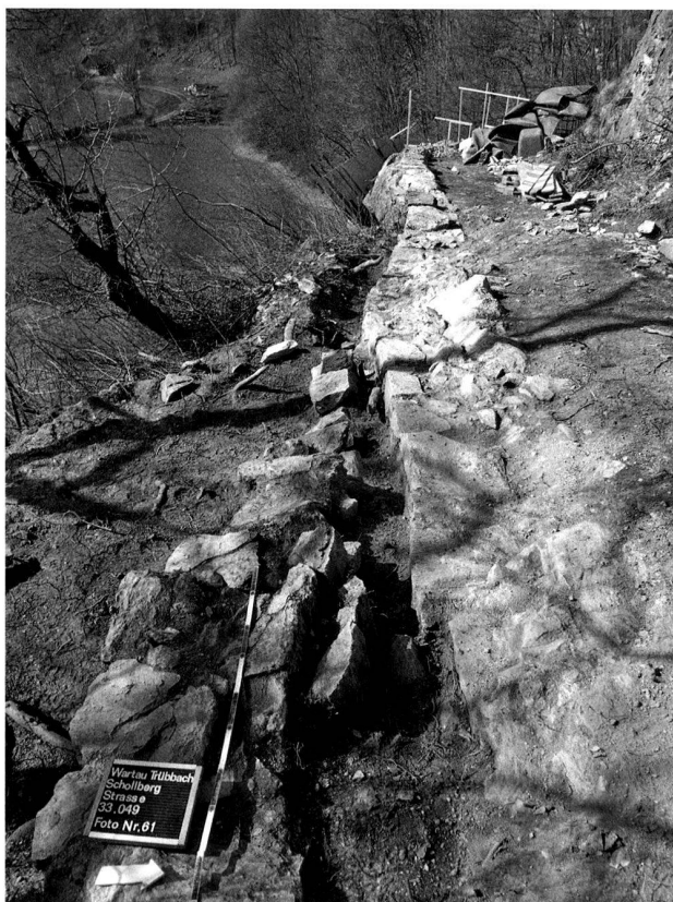
Abb. 52. Wartau SG, Alte Schollbergstrasse. Wegstrecke bei der exponierten Stelle an der Hohwand: Eine Stützmauer (rechts im Bild) sichert die Strasse an der steil abfallenden Felskante (ganz hinten im Bild). Sie wurde durch eine jüngere Stützmauer (links im Bild) bei einer Strassenverbreiterung ersetzt. Foto KA SG.
