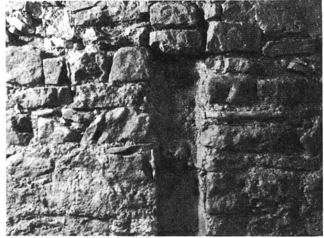
Abb. 9. Negativ eines Holzbalkens von der Unterfangung des Turmes anlässlich der Errichtung der jüngeren Stadtmauer.
