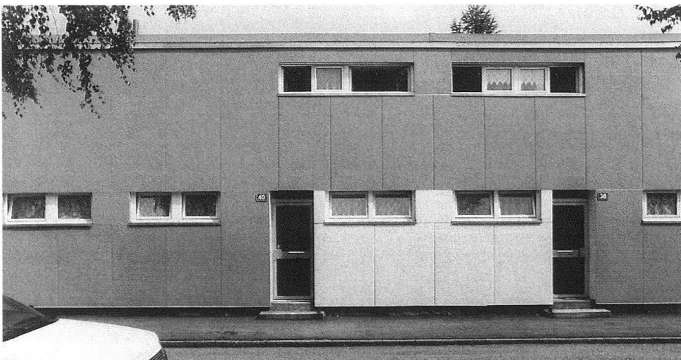
6 Ansicht einer Zeile nach der Fassadenisolation mit olivgrünen und hellgelben Platten, Zustand 1989.
