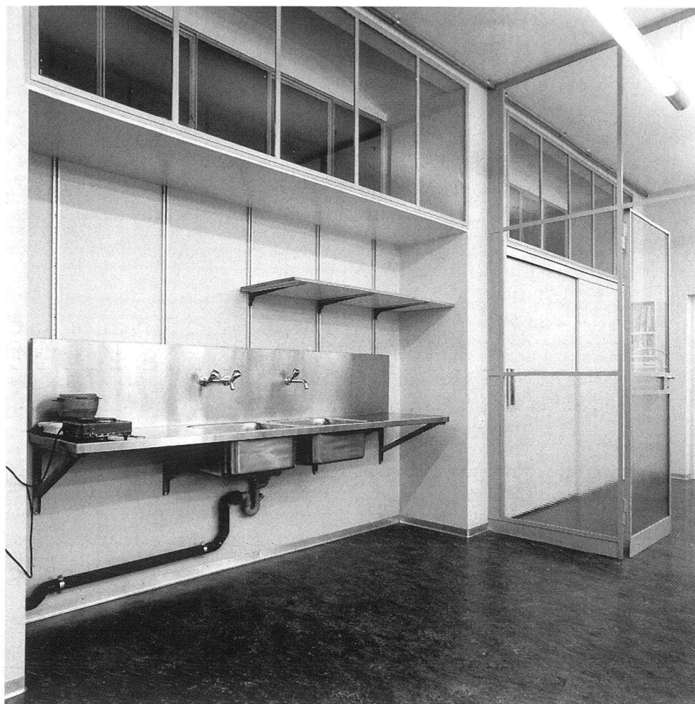
17 Gewerbeschule und Kunstgewerbemuseum Zürich, Weiterbildungs-klasse Schmuck und Ge-rät. Reprofiliiert 1987. Neue Elemente: Beleuch-tung, Glastrennwand, Nasszone, Schrankfront.
