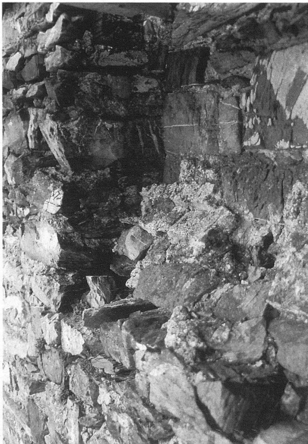
2 Mauerwerksteile vor Durchführung der Sanierung.
