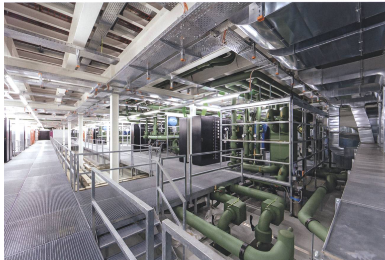
Piano distribuzione: dettaglio del circuito di raffreddamento di Piz Daint.
