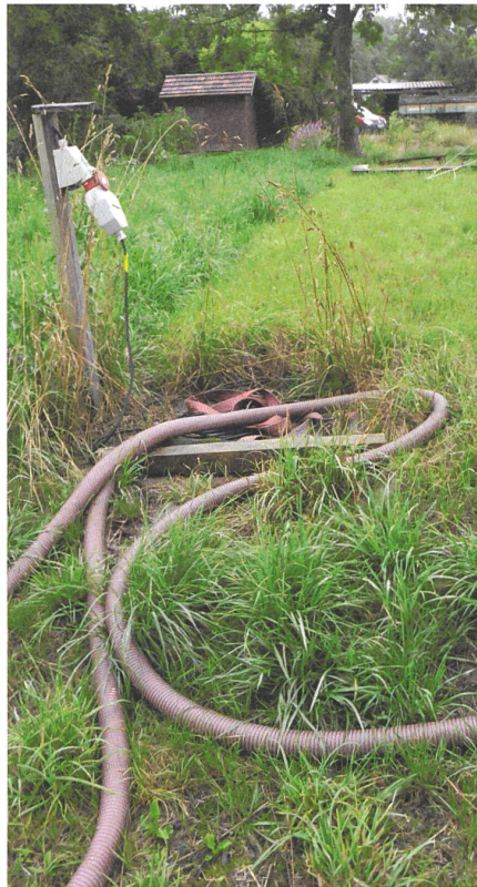
Ein Starkstromanschluss in Zisternennähe erleichtert die Wasserentnahme beträchtlich, weil so die Tiefbrunnenpumpe im Sommer in der Zisterne bleiben kann und nur ein Schalter bedient werden muss.
