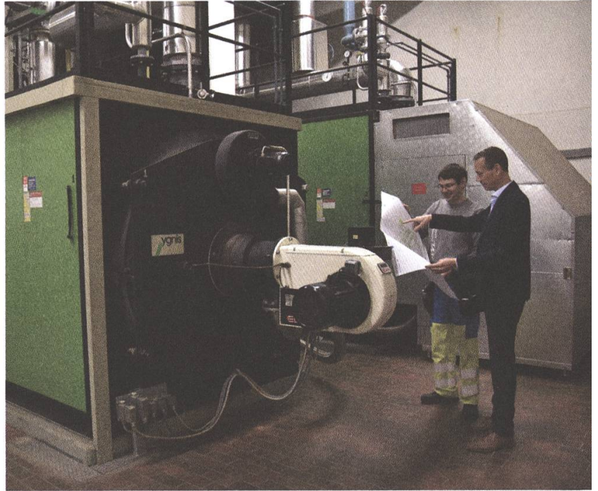
Die Gaskessel in der SWL-Heizzentrale sind in die Jahre gekommen und werden ersetzt zvg
