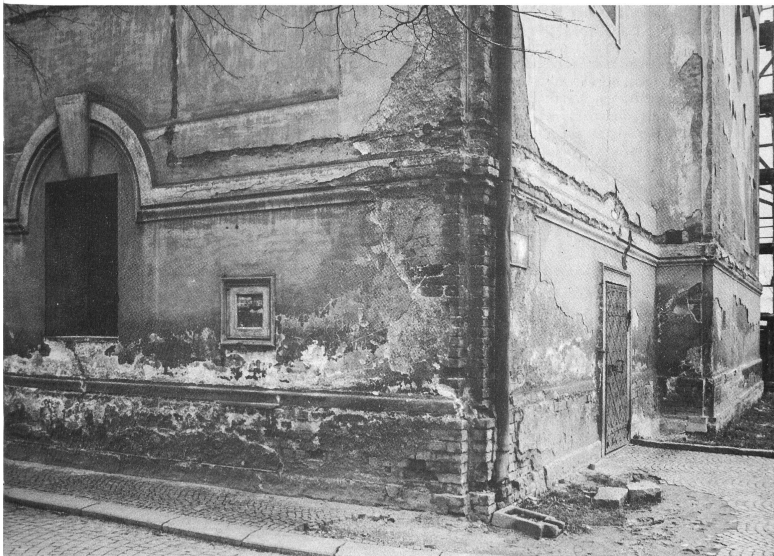
Der ruinöse Zustand der Kirchengebäude – Symbol einer unterdrückten Christengemeinde
