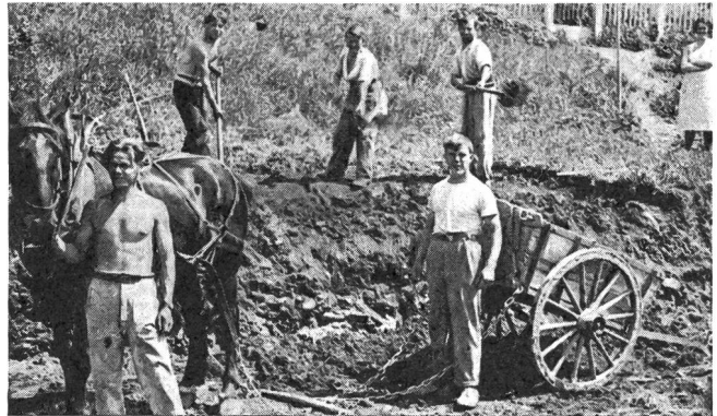
Unsere Equipe bei den Erdbewegungen Notre équipe exécutant les mouvements de terre
