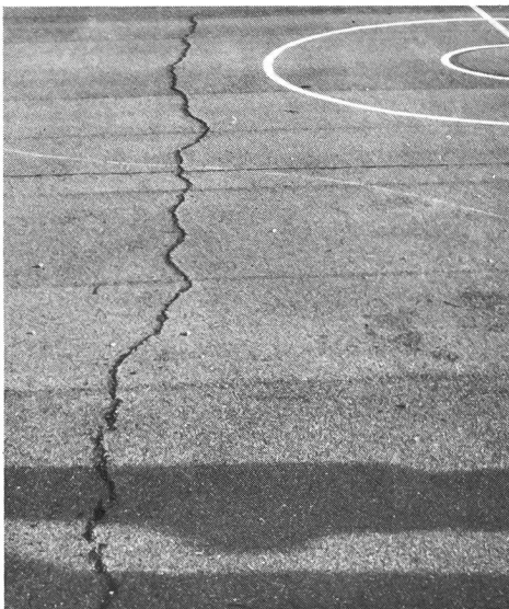
Risse im Belag eines Trockenplatzes.
