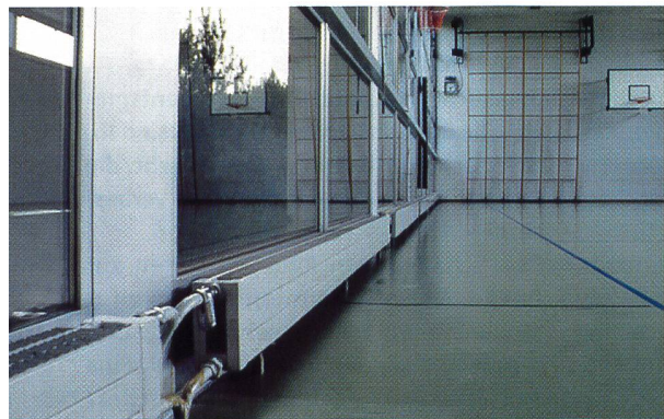
Gefahrenstelle unverkleidete Heizkörper.
