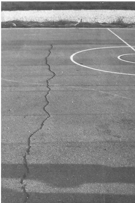
Place sèche: une fissure bien mal venue.
