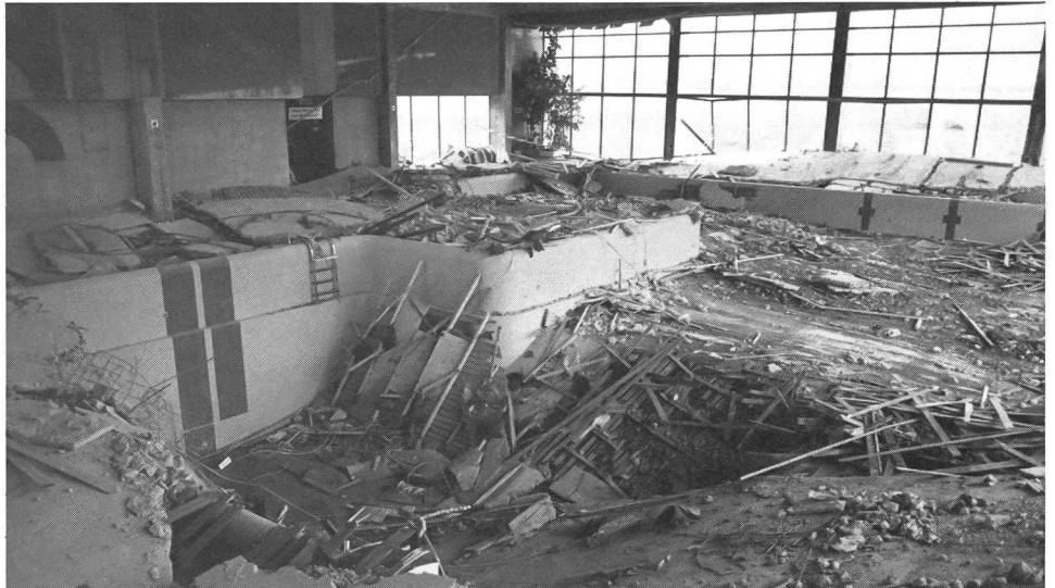
On ne voit plus les dégâts, mais il y eut aussi une tragédie humaine: le 9 mai 1985, le toit de la piscine d'Uster s'écroule...
