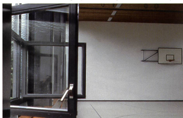
Une fenêtre ouverte... l'accident garanti.
