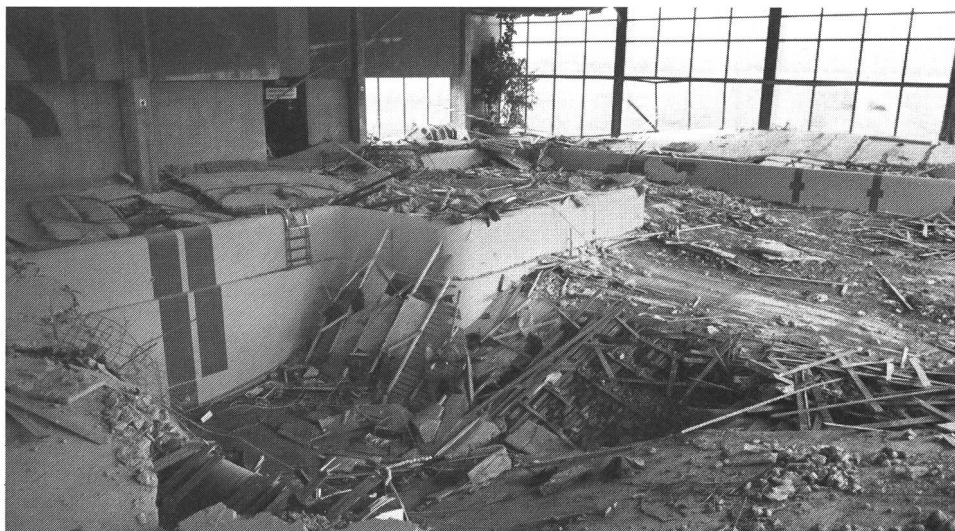
Danni ingenti e tragedia umana: il 9 maggio 1985 crolla il tetto interno della piscina di Horgen.
