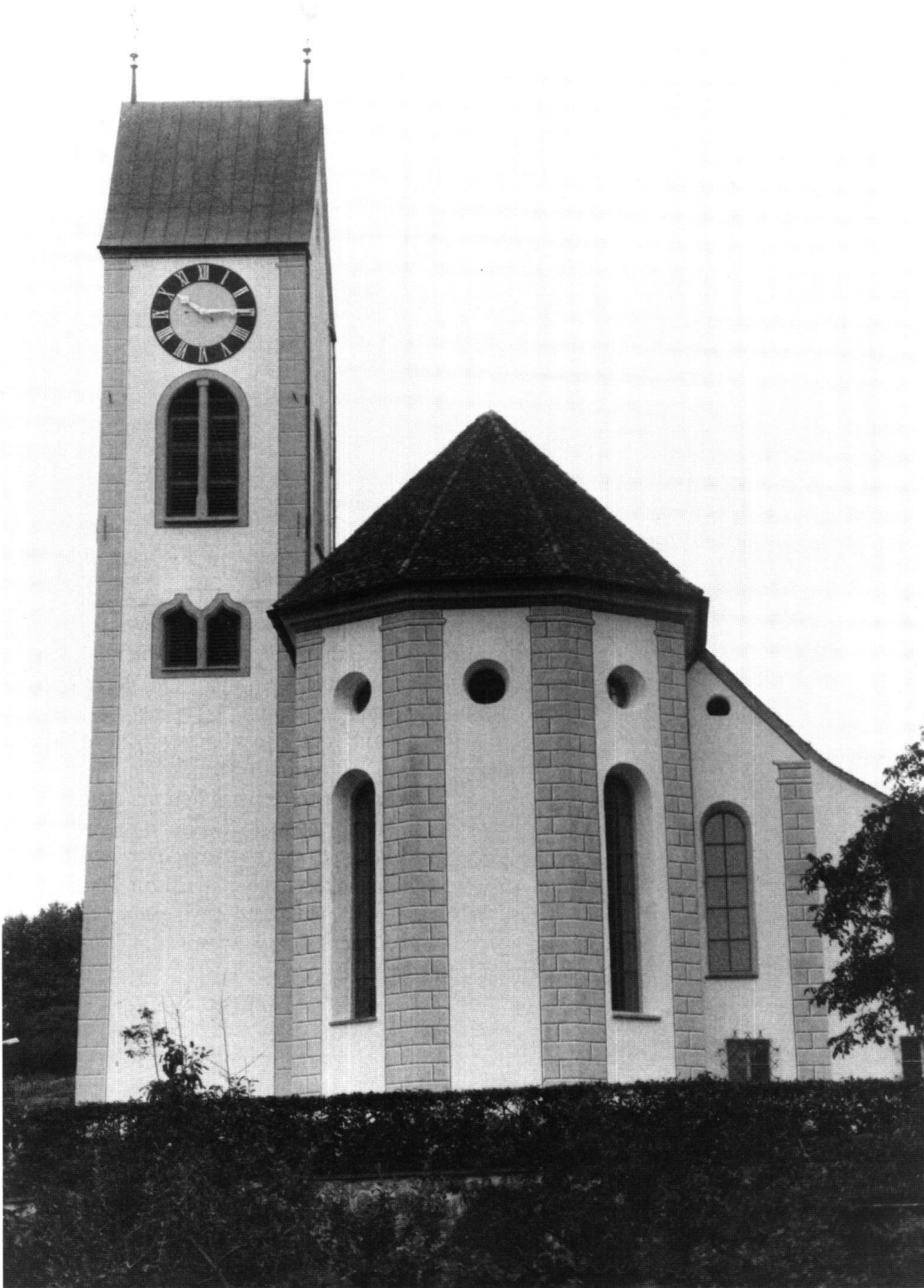
Abb. 23: Tuggen, Pfarrkirche St. Erhard. An den Fassaden des Chores, des Schiffs und am Turm wurde die kräftige Architekturbe- malung anhand des Befundes wiederhergestellt. Die grossflächig original erhaltenen Partien wur- den konserviert und integriert.
