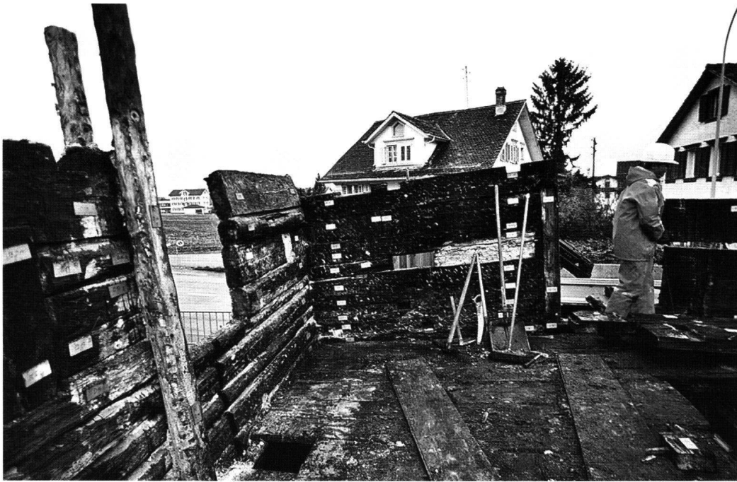
Abb. 44: Das Haus Nideröst beim Abbau im November 2001: Obergeschoss gegen Westen, links eine der beiden Blockzangen.
