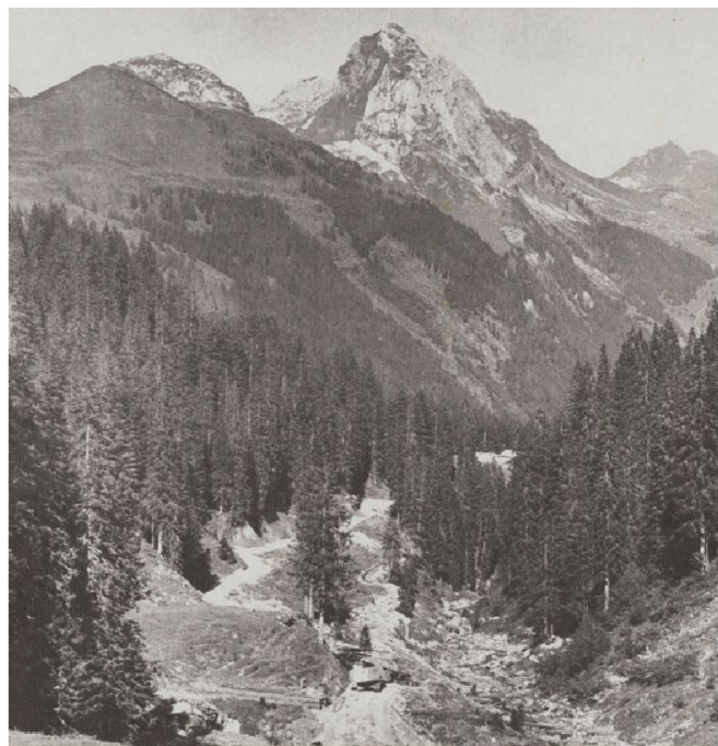
Abb. 4: Aufnahme beim Bau der Prugelstrasse durch das Militär beim Klöndurchlass, Richtung Glarner Grenze, zwischen 1970 und 1974. Die Militär-, Alp- und Forstwirtschaftsstrasse weist gegenüber allen früheren Projekten und dem Saumpfad eine neue Strecken-Führung auf, zum Beispiel auf der westlichen Pass-Seite vom Roggenloch her durch den Bödmerenwald, nicht direkt zum Prugelpass.
