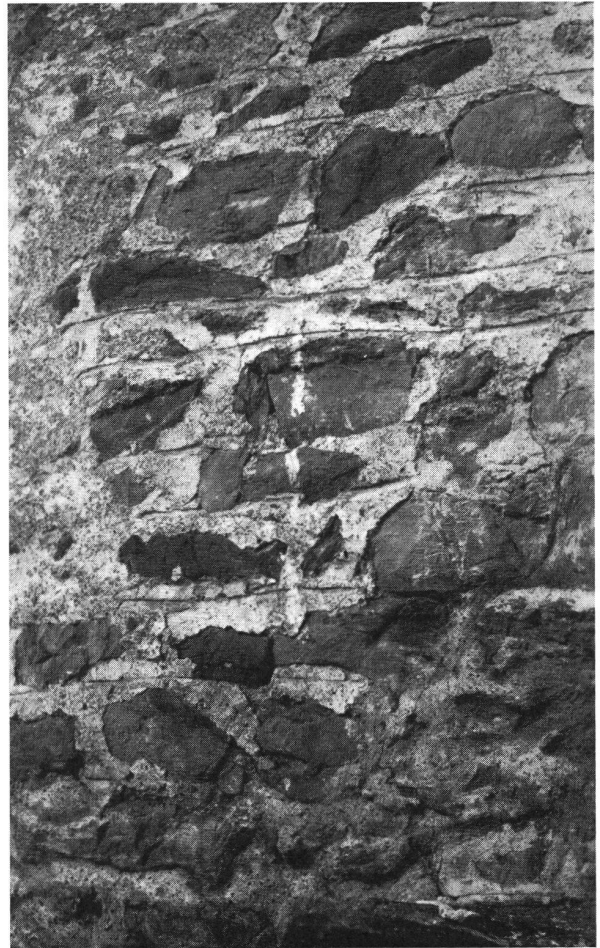
Gräpplang bei Flums SG. Burgruine. Romanischer Verputz am Palas mit den rot bemalten Chellenstrichfugen.
