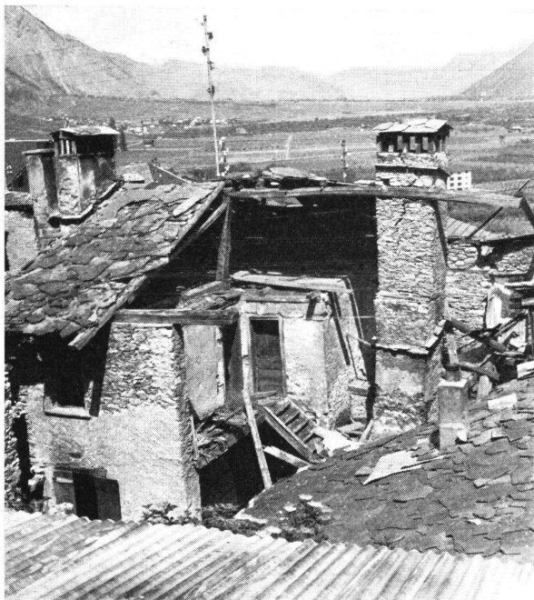
Saillon VS ... von der Rückseite besehen ist der Schaden um einiges schlimmer. Die Dachpartie mußte inzwischen wegen Einsturzgefahr abgetragen werden.
