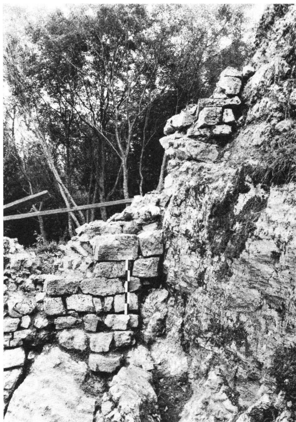
Frohburg. Reste der südlichen Ringmauer, freigelegt 1973. Das ausgezeichnete Quadermauerwerk ruht direkt auf dem Fels auf.
