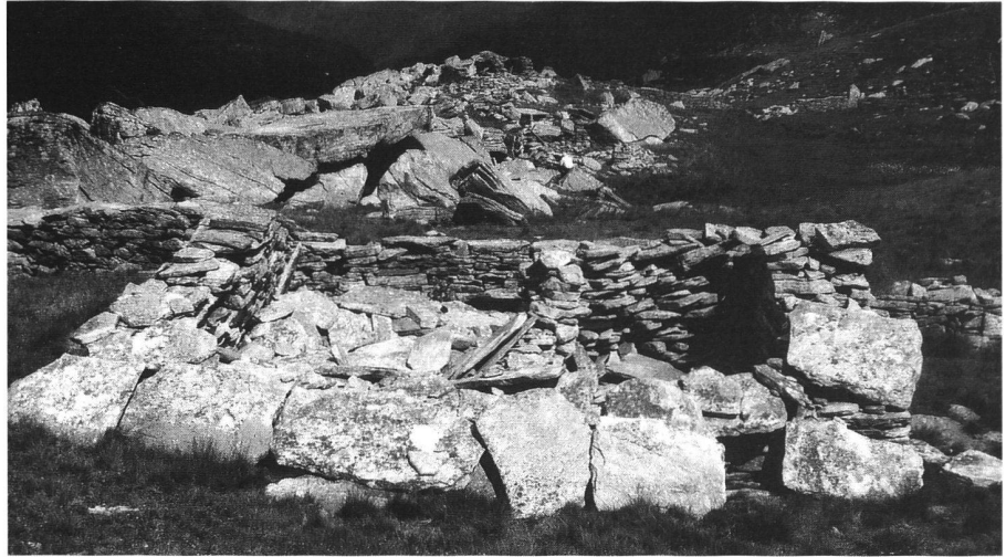
24: Vals GR, Blachtenalp. Eingestürztes Steinplattendach eines ehemaligen Alpwirtschaftsgebäudes.
